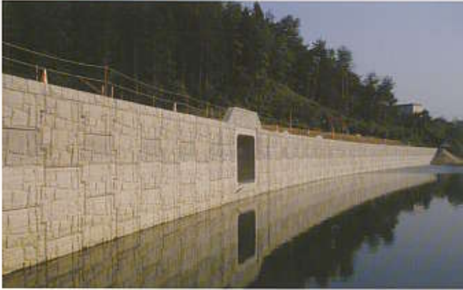
秋田県 / 明永2期地区ふるさと農道 総壁面積 1,531m 2 壁高 10.5m
